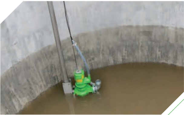
FÖRDERUNG DER AUFBEREITETEN GÜLLE ZUM SPEZIELLEN PRESSSCHNECKENSEPARATOR
