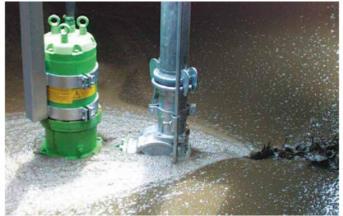
Alimentación del sistema con una bomba trituradora especial de motor sumergible
